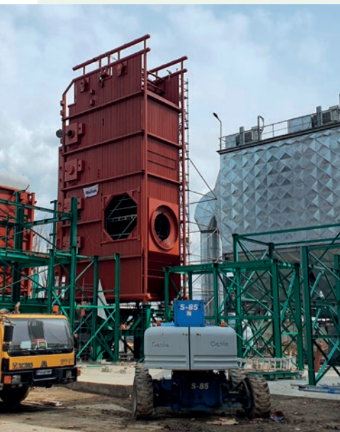
Unité de cogénération Expur, Roumanie
